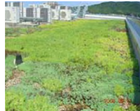
屋上緑化(NJR福岡)
